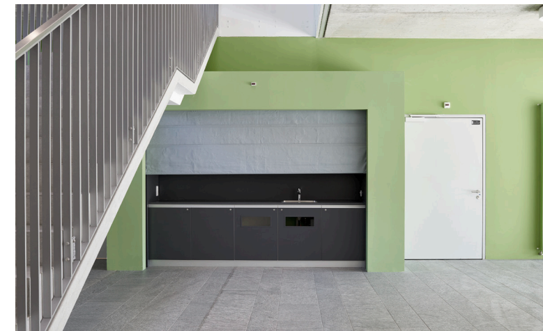
Feuerschutzvorhang in der Universität EPFL in Lausanne
